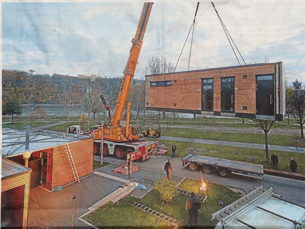
Bislang werden die Container auf dem Campingplatz, die Sanitäranlagen und Gastronomie beherbergen, aufwendig abgebaut und im Winterhalbjahr eingelagert. Nun sollen sie nur im Fall eines Hochwassers aufgebockt werden – sodass der Campingplatz auch im Winter geöffnet sein könnte. Foto (Archiv): Frey
